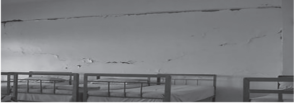
Dolgu duvar ile taşıyıcı çerçeve arasındaki sıva çatlakları
