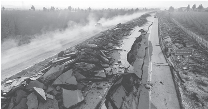
Maraş merkezli depremde sıvılaşmaya bağlı fay hattının vurduğu karayolu
