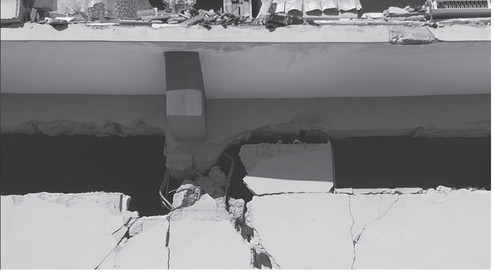
Gaziantep Nurdağı deprem sonrası yapıda oluşan kısa kolon hasarı
