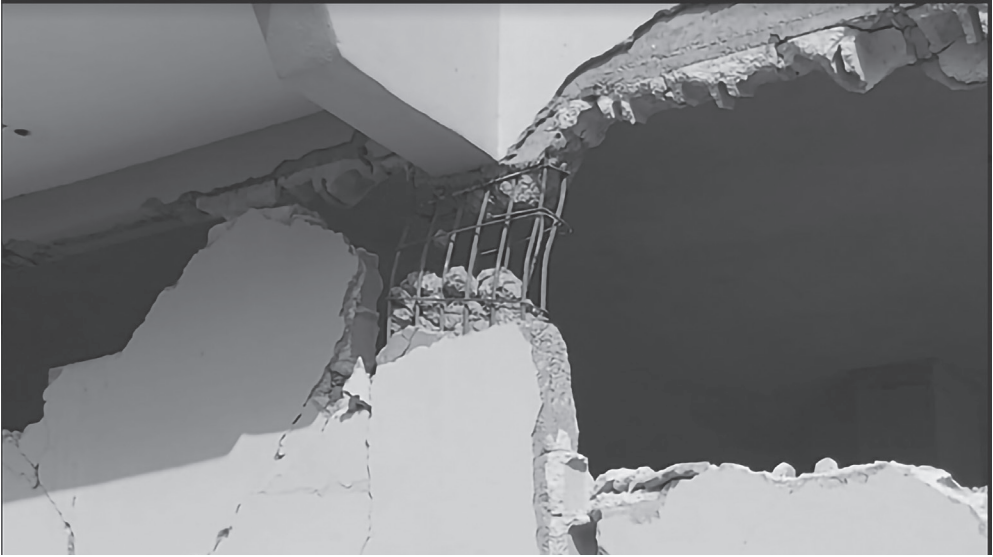
Gaziantep ili Nurdağı ilçesi deprem sonrası kolonda yetersiz etriye donatısına bağlı hasar alma durumu
